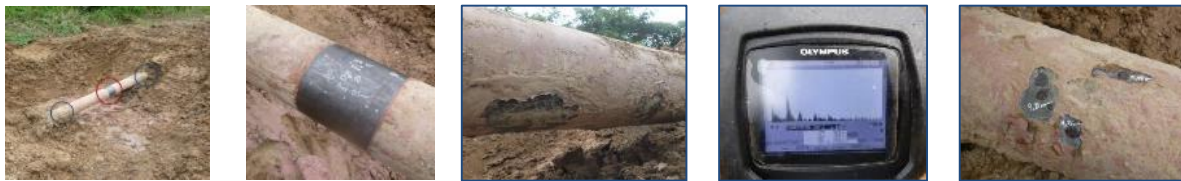
Figura 3. Evidencia de defecto de recubrimiento tipo “ampollamiento” tanto aguas arriba como aguas abajo de zona preparada superficialmente. ALARMA 1 en zona ampollada en posición horaria 06:00, 5.05 mm medidos por ultrasonido.
