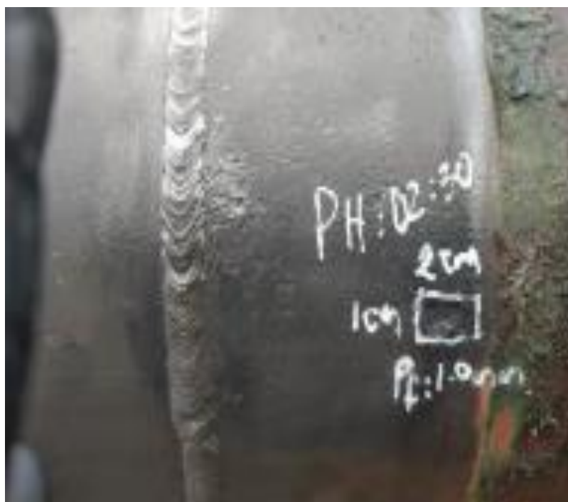
Figura 1. Corrosión leve en zona información tomada de documento PI_102_Insp. Excavaciones Jibas 10in Rev.3
